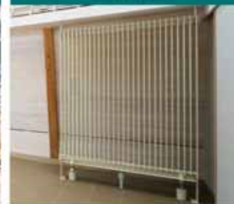
地熱利用輻射冷暖房システム
